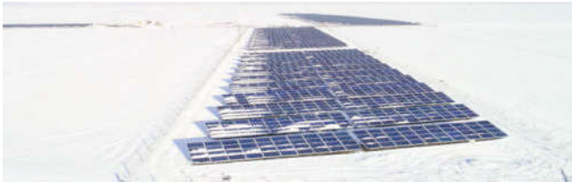
ARAZİ ÜZERİ FOTOVOLTAİK GES 2017
