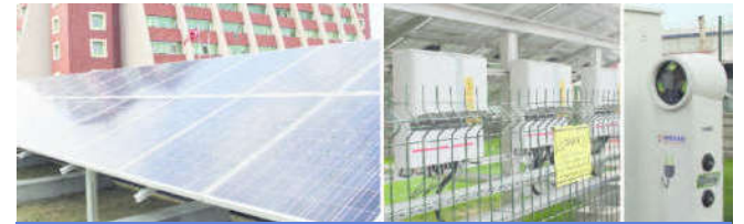
ARAZİ ÜZERİ FOTOVOLTAİK GES 2014
