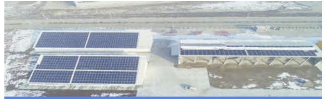
ÇATI ÜZERİ FOTOVOLTAİK GES 2017
