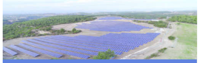
ARAZİ ÜZERİ FOTOVOLTAİK GES 2017
