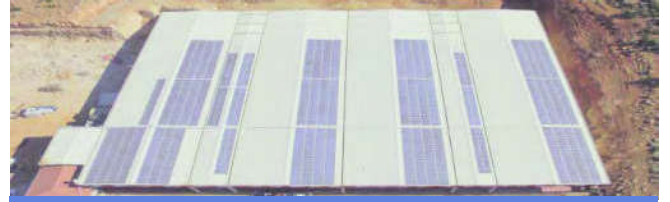
ÇATI ÜZERİ FOTOVOLTAİK GES 2016
