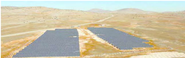
ARAZİ ÜZERİ FOTOVOLTAİK GES 2016
