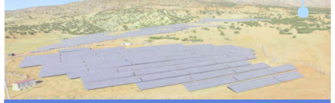
ARAZİ ÜZERİ FOTOVOLTAİK GES 2016
