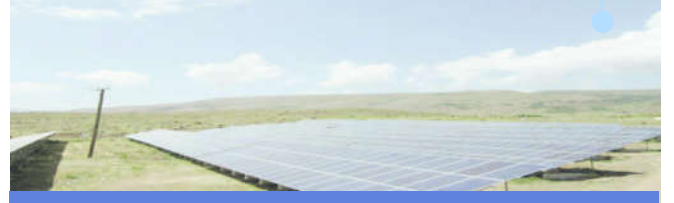
ARAZİ ÜZERİ FOTOVOLTAİK GES 2017
