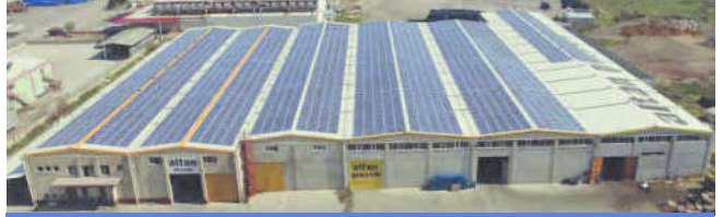
ÇATI ÜZERİ FOTOVOLTAİK GES 2017
