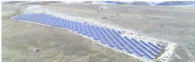
ARAZİ ÜZERİ FOTOVOLTAİK GES 2017
