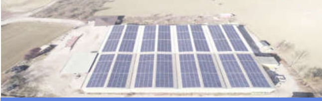
ÇATI ÜZERİ FOTOVOLTAİK GES 2017
