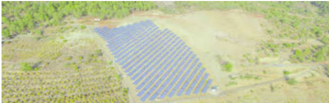
ARAZİ ÜZERİ FOTOVOLTAİK GES 2016
