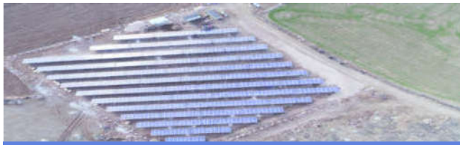
ARAZİ ÜZERİ FOTOVOLTAİK GES 2017
