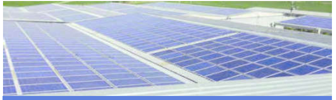
ÇATI ÜZERİ FOTOVOLTAİK GES 2015
