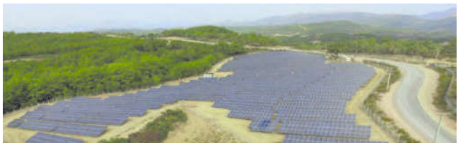
ARAZİ ÜZERİ FOTOVOLTAİK GES 2016
