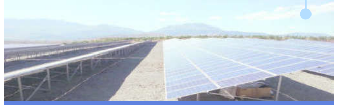
ARAZİ ÜZERİ FOTOVOLTAİK GES 2016
