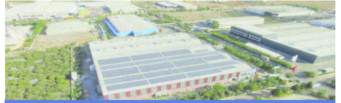
ÇATI ÜZERİ FOTOVOLTAİK GES 2016
